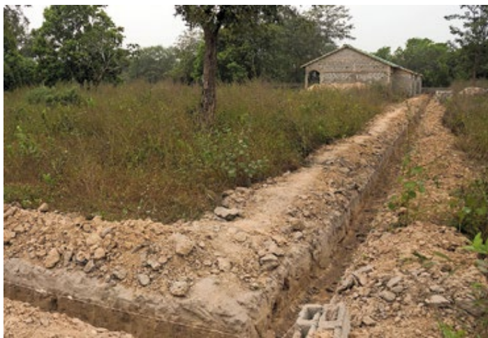
In deze geulen komt de fundering voor hoge muren; het safehouse voor vrouwen en kinderen bij Pancholi heeft bescherming nodig.
